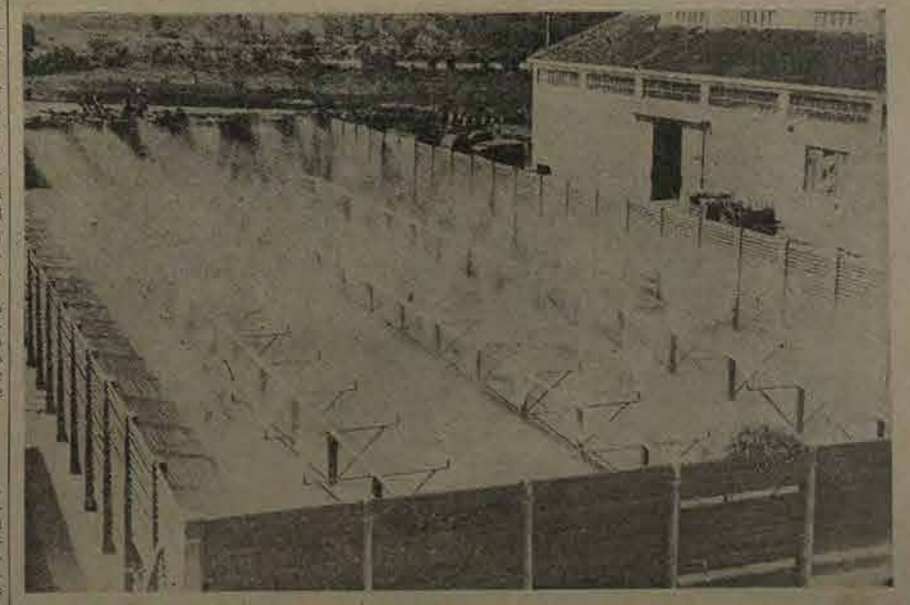
Dispositivo de refrigeración que funciona en la planta fabril que la Dirección de Fabricaciones Militares posee en Patipalá donde se elaboran los metales extractados de las minas de Zepia.
